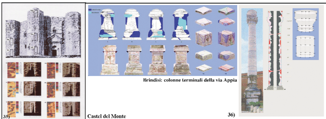
Figg. 33-36. La tecnica analitica ICAW viene impiegata per informazioni sia di carattere puntuale, legate a locali manifestazioni di danno in superficie e in profondità (figg. 33-34), sia a livello più generale, per verifiche su superfici interessate da sostituzioni di materiale lapideo nel corso di restauri (fig. 35). Tale impiego trova, inoltre, applicazione per definire il rapporto tra stato di alterazione, fessurazione e proprietà fisico-meccaniche del materiale lapideo degradato (fig. 36).
