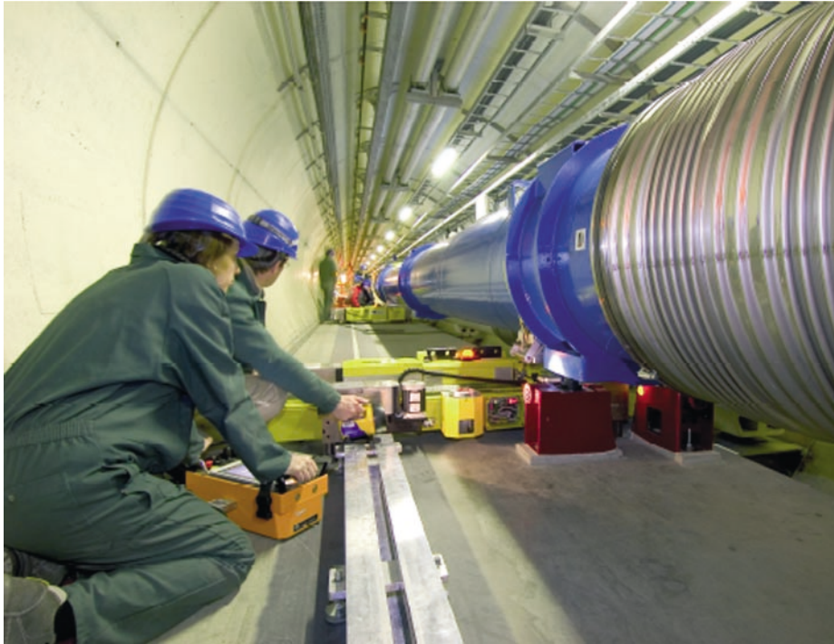
Fig. 3 - Lavori di installazione dei magneti superconduttori di LHC (le strutture in blu) nel tunnel sotterraneo del CERN.
